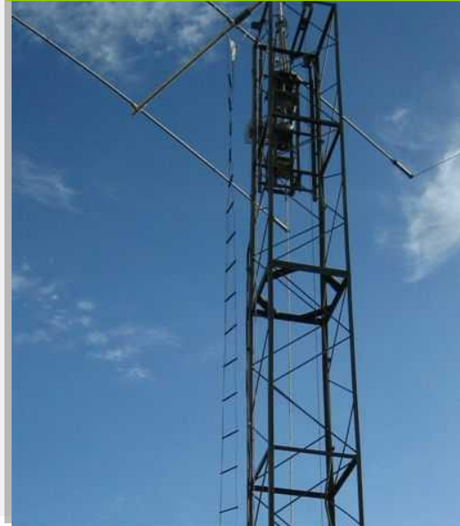
LE FEEDER LE LONG DU PYLONE.
